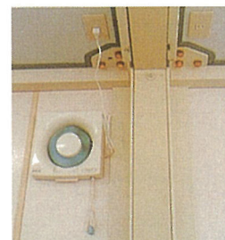
連棟部換気扇側
