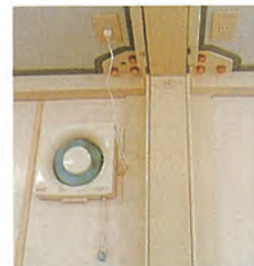
連棟部換気扇側
