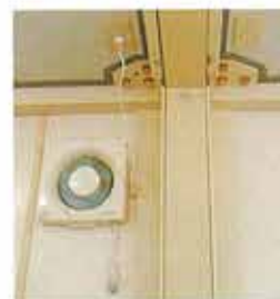
連棟部換気扇側
