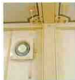
連棟部換気扇側
